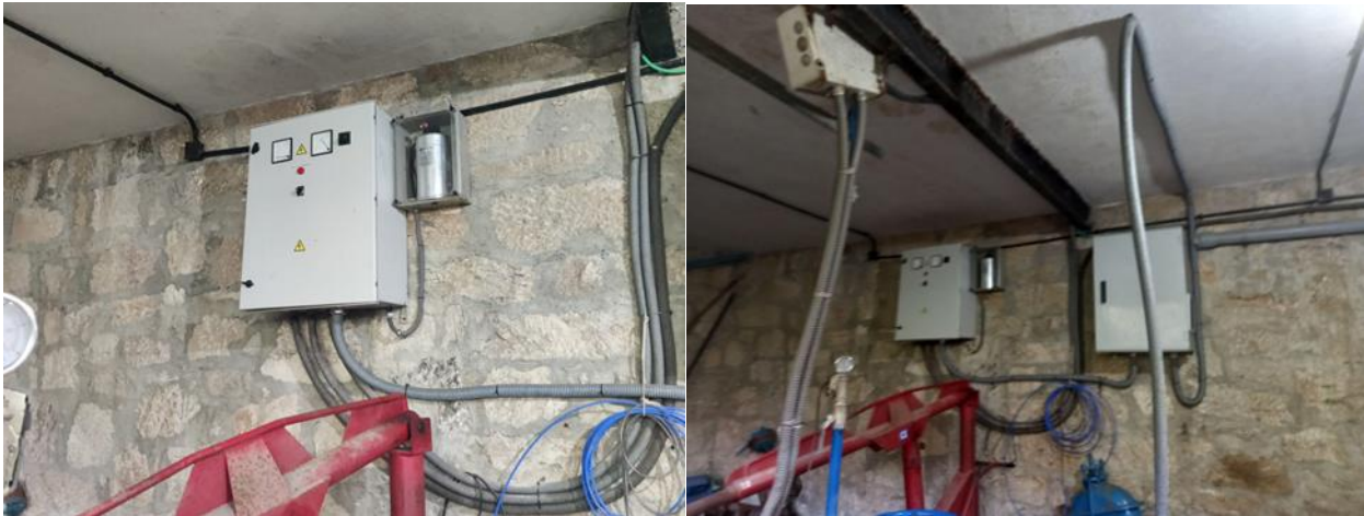
Foto 13.. Cadros eléctricos bombeo A Barca
