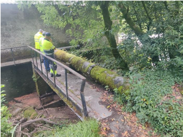
Foto 8.. Condución de saída do Bombeo de A Barca
