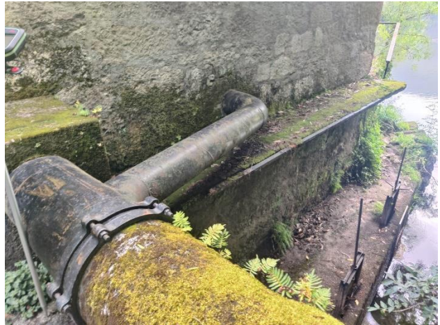
Foto 9.. Unión das conducións dos bombeos coa saída principal
