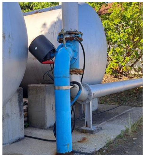
Foto 16.. Entrada condución na ETAP.
