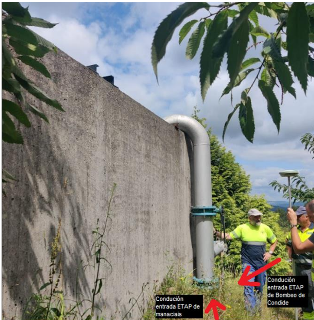
Foto 20. Conducción de entrada á ETAP de Condide
