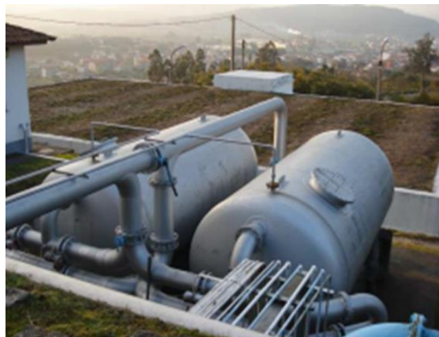
Foto 24 Filtros da ETAP de Condide
