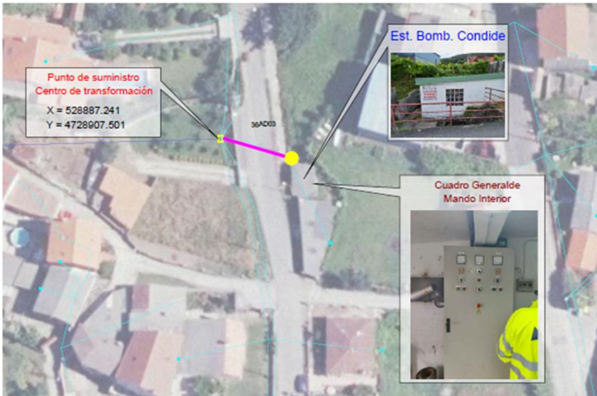
Foto 18.. Subministro eléctrico estación de Bombeo de Condide
