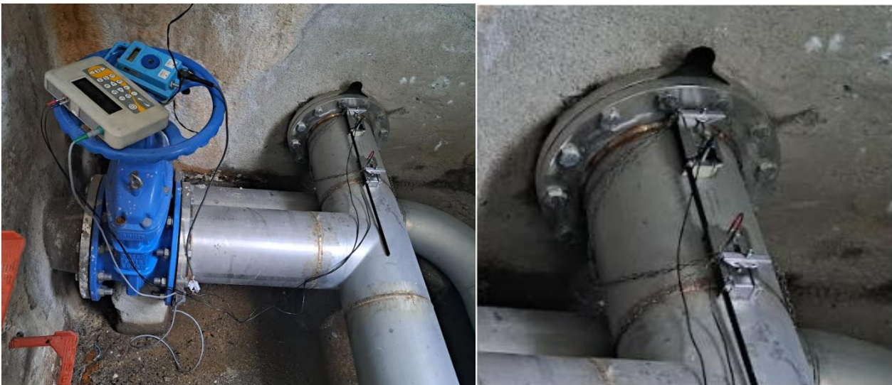
Foto 31. Contador ultrasónico colocado na saída do depósito da ETAP de Condide
