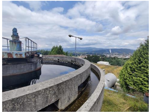
Foto 23. Decantador da ETAP de Condide
