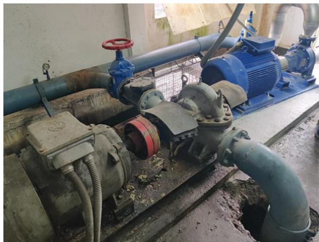
Foto 19. Bombeo de Condide
