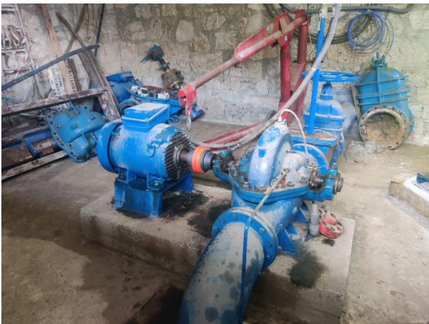
Foto 10.. Bomba I do Bombeo de A Barca
