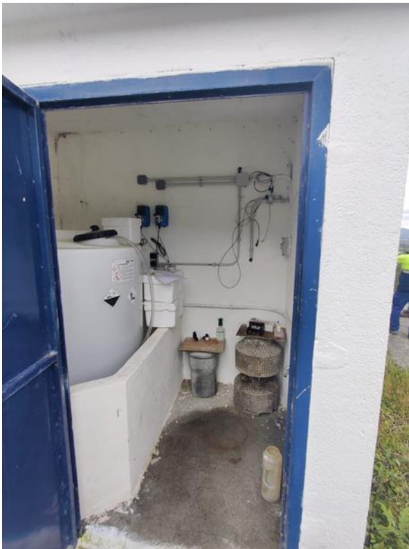
Foto 26. Sala dosificación do desinfectante da ETAP de Condide (sen servizo)
