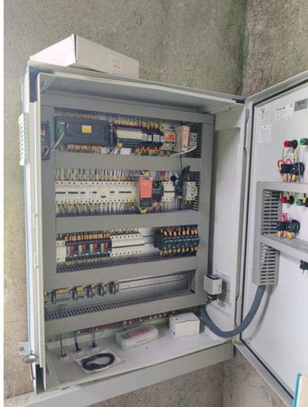
Foto 27. Cadro eléctrico do depósito na ETAP de Condide
