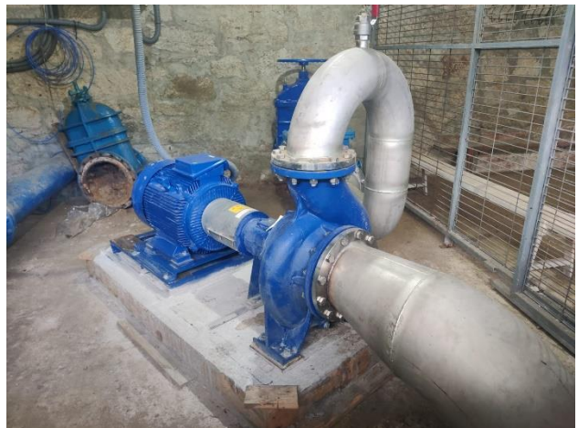
Foto 11.. Bomba II do Bombeo de A Barca
