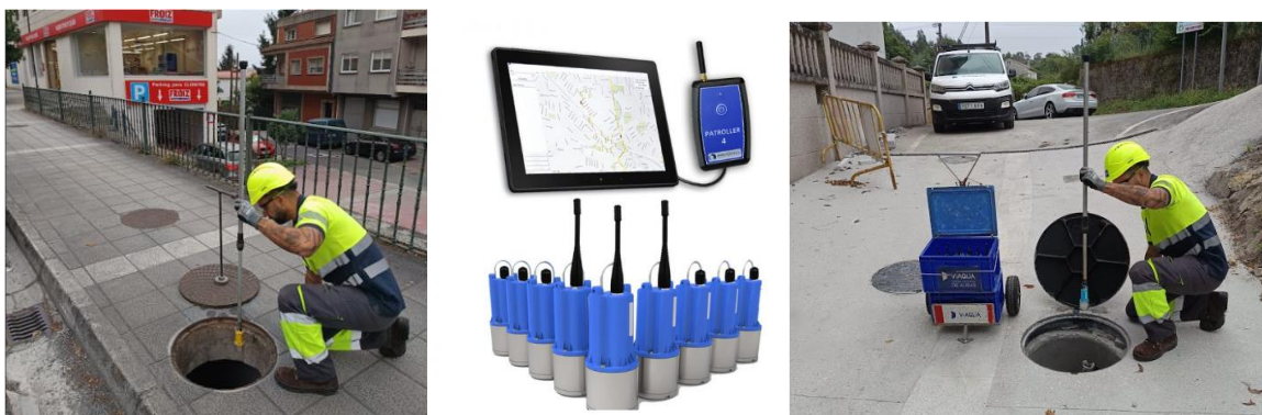
Foto 33. – Localización de fugas de auga acústico mediante equipos Pcorr®+
